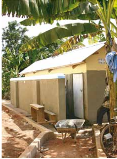
eines der neuen Sanitärgebäude
