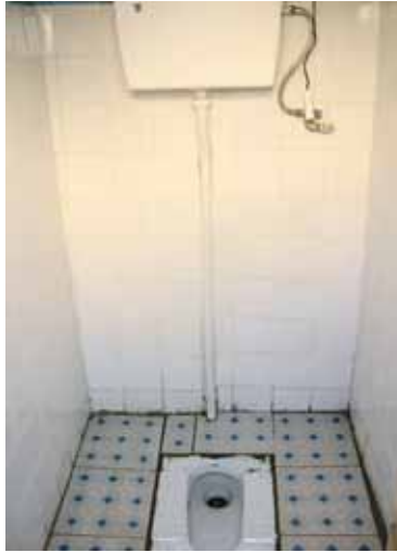
neue WC mit Wasserspülung
