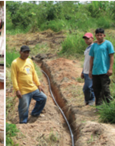
In Fronarbeit verlegen die Einheimischen eine Leitung von 100 Meter Länge für eine zweite Wasser-Entnahmestelle im Dorf.
