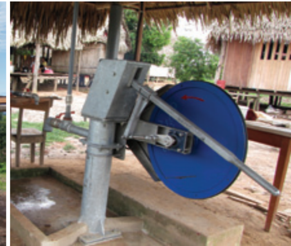
Die neue Grundwasser-Pumpe mit Solarstromantrieb ist montiert. Sie fördert genügend sauberes Wasser für die ganze Siedlung. Notfalls kann die Pumpe auch von Hand betrieben werden.
